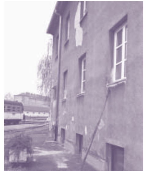
Nevarnost odpadanja ometa na zgradbi sekcije za vleko Maribor, kaže zgovorno sliko tega, da se za vzdrževanje in opremo objektov v sekcijah namenja premalo sredstev.
